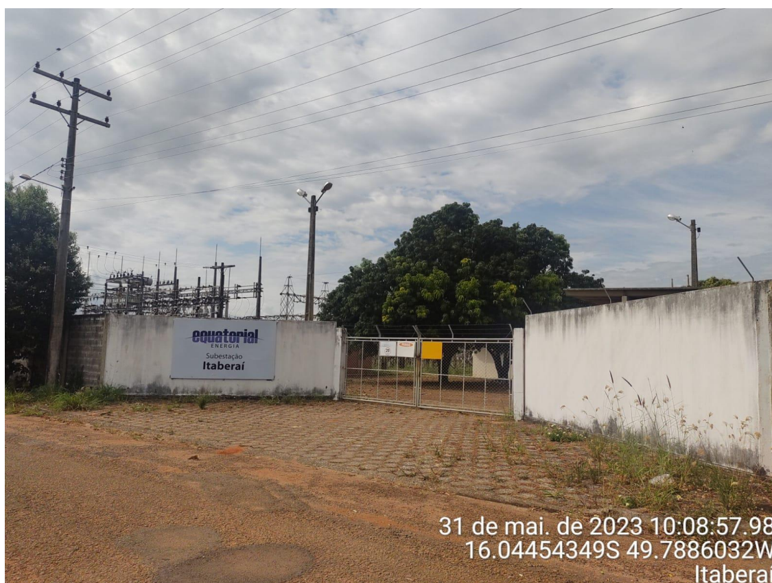
Figura 5.77: Subestação de energia elétrica Itaberaí gerenciamento pela Equatorial Goiás. Fonte: ITCO (2023).
