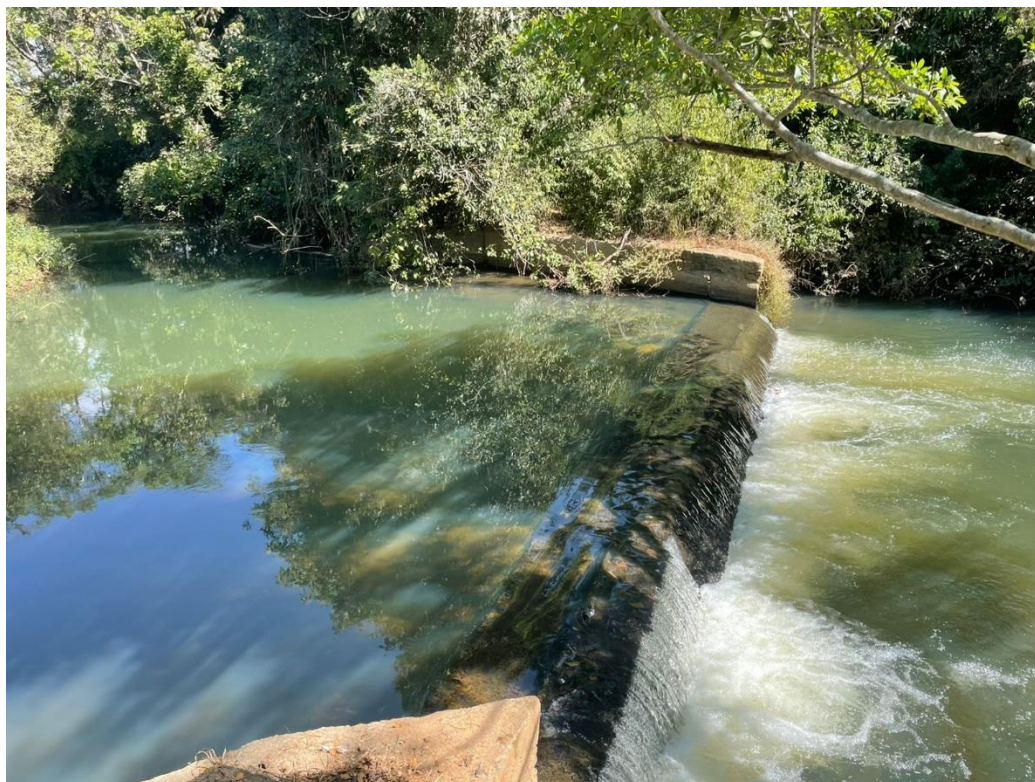
Figura 5.63: a) ponto de captação no Rio das Pedras com barragem de nível para a tomada de água.
