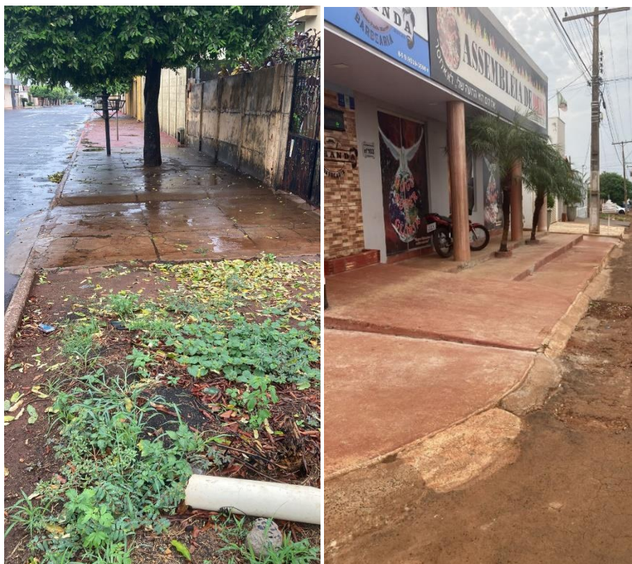
Figura 6.45: Arborização e poste mal localizados no passeio público.
