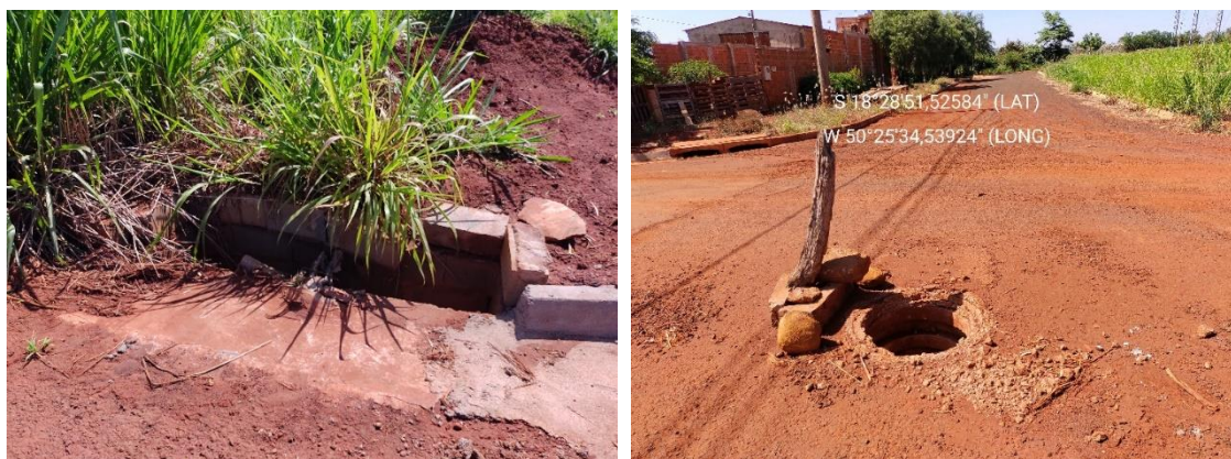
Figura 5.76: Boca de lobo com estrutura danificada e acúmulo de vegetação e poço de visita sem tampa. Fonte: ITCO (2022).
