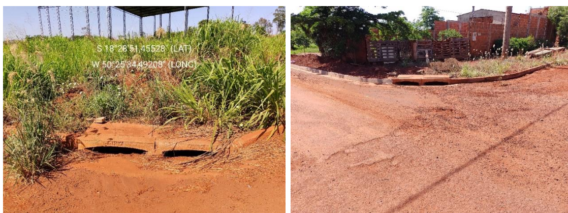
Figura 5.75: Dispositivo de drenagem em Quirinópolis. Fonte: ITCO (2022).
